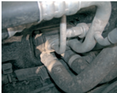
Zawór rozprężny układu klimatyzacji.
