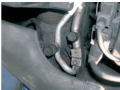
Przyłącza serwisowe układu klimatyzacji.
